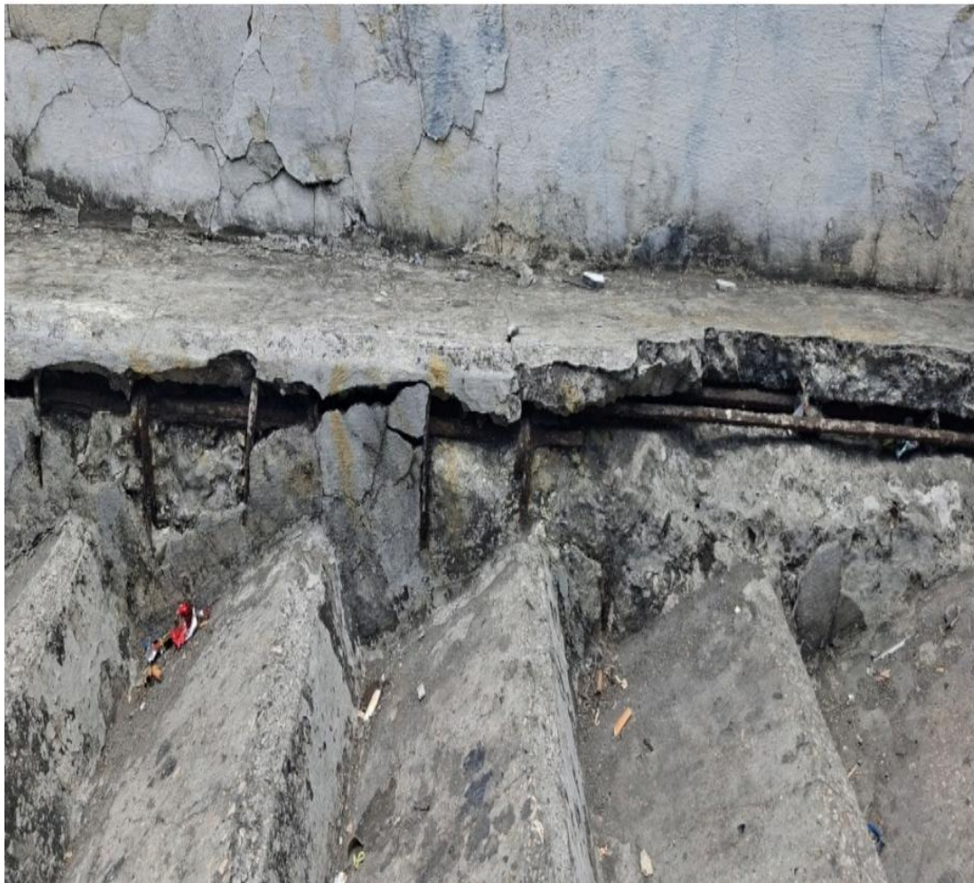
Ilustración 39. Desgaste superficial en la parte de la escalinata
