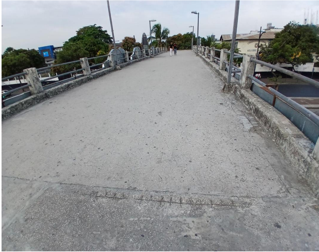
Ilustración 40. Tablero del paso peatonal Aguirre Abad, a primera vista, la superficie de hormigón presenta agrietamiento y desgaste
