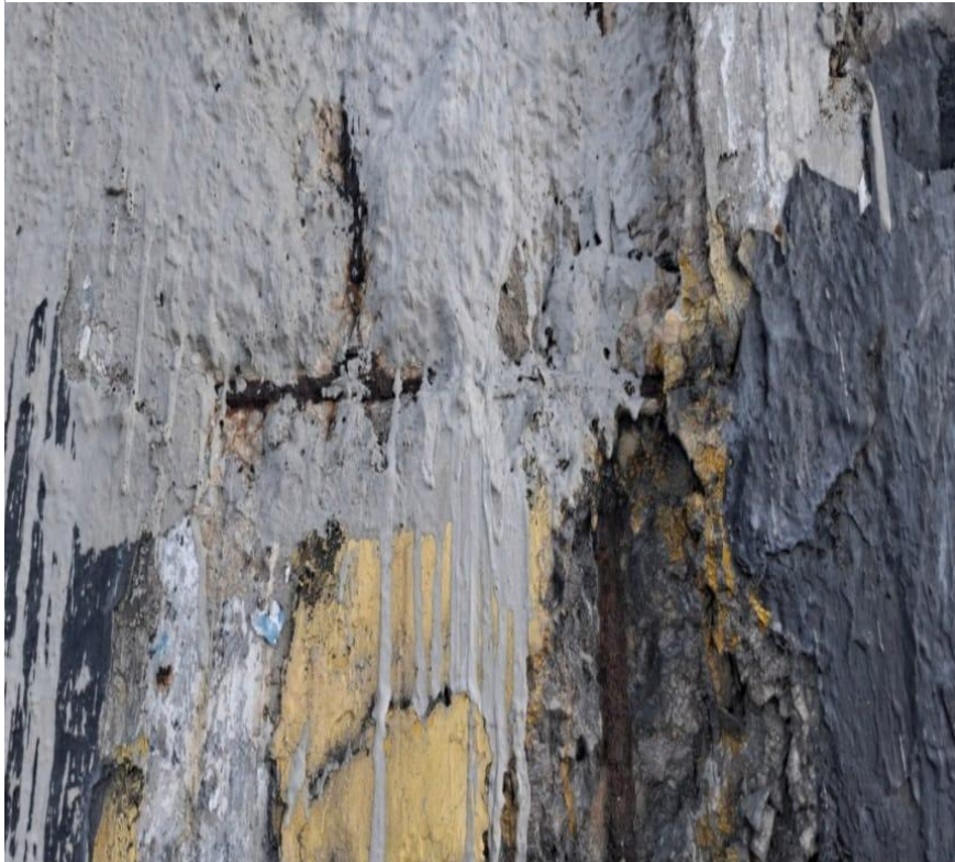
Ilustración 38. Corrosión en la armadura estructural
