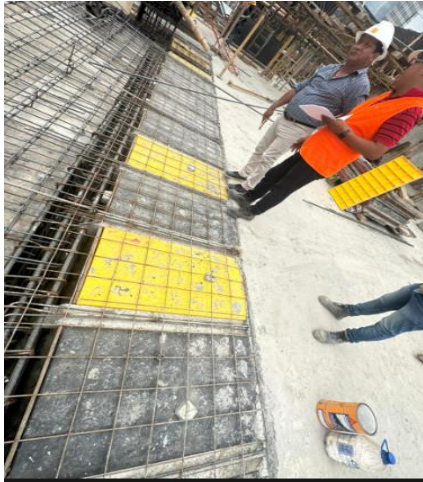
Figura 3. Comportamiento de encofrado después de una fundición de losa
