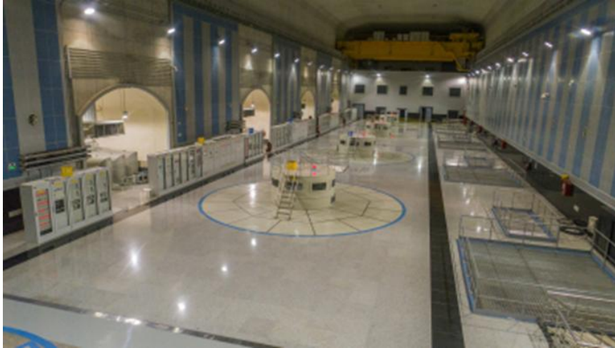
Figura 8 Casa de máquinas
