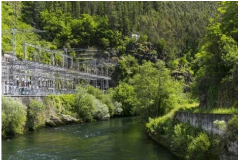
Figura 1 Central de agua fluyente
