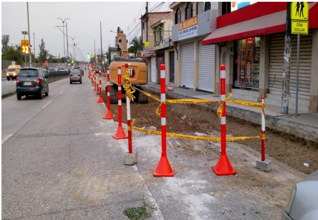
Ilustración 11: Levantamiento de paños agrietados
