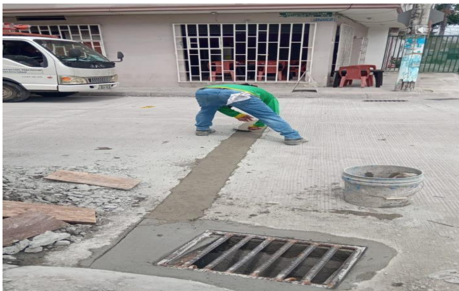
Ilustración 6: Reparación de fisura pavimento
