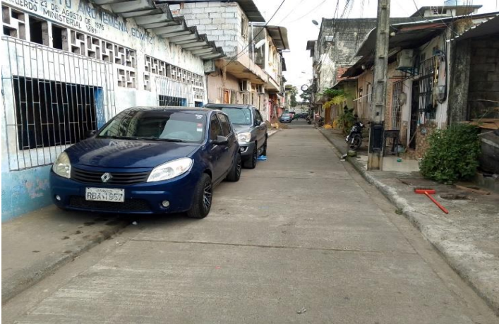
Ilustración 88. Estado de la Vía
