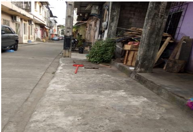
Ilustración 87. Estado de Acera
