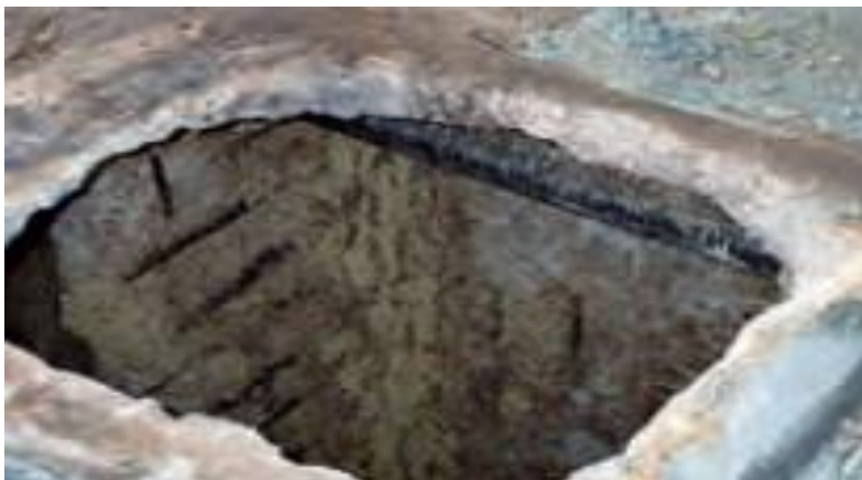
Figura 32 Cámara de descarga en Singapur - inicialmente protegida por una membrana plástica
