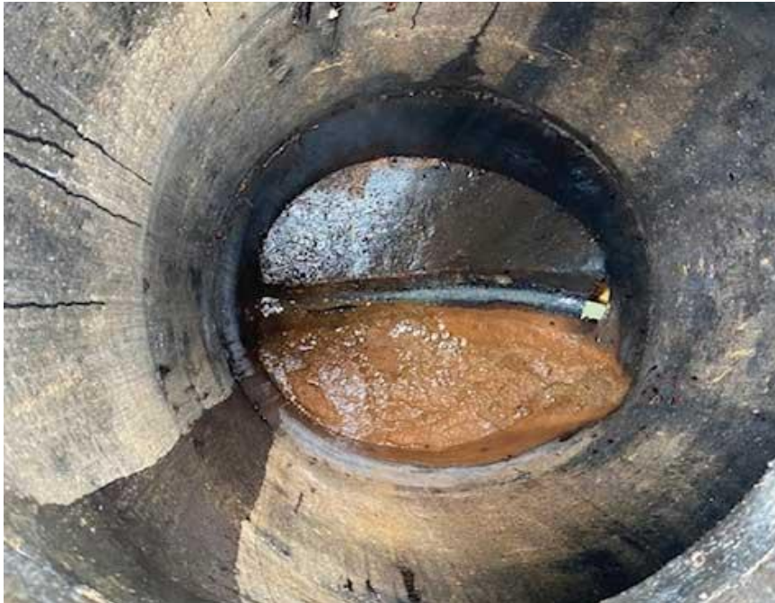
Figura 6 Comprensión de la corrosión biogénica y su efecto en la infraestructura de recolección de aguas residuales de cemento Portland
