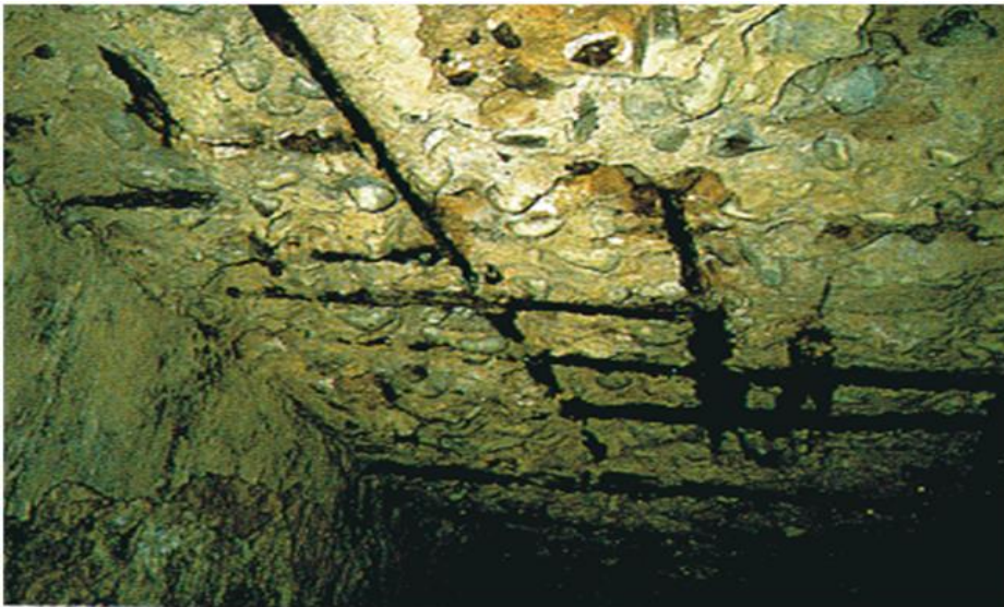
Figura 12 Cámara de concreto básico
