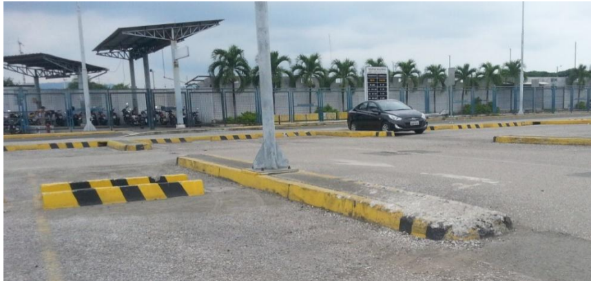
Figura 27. Condiciones actuales de las aceras y bordillos.
