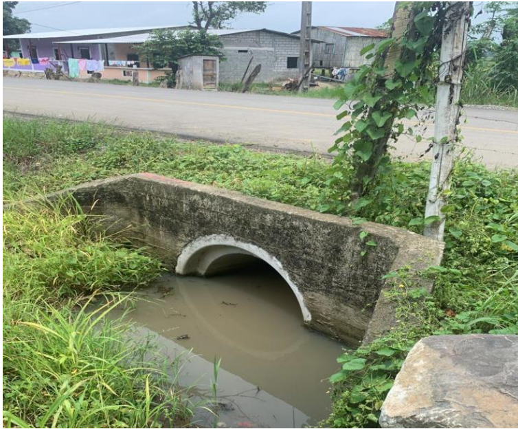
Figura 19 Tuberías de aguas lluvias del sector
