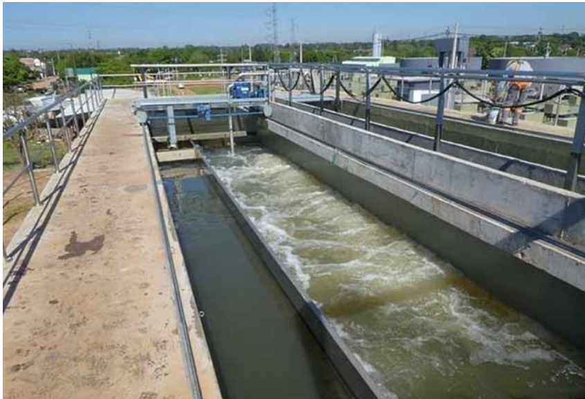
Ilustración 14: Planta de Tratamiento de Aguas Residuales (PTAR).
