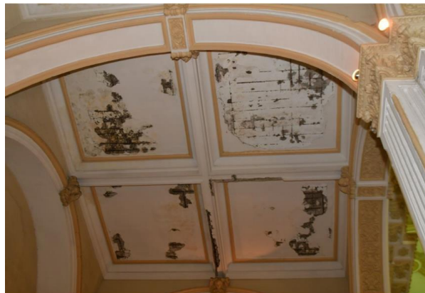
Figura 8 Muestra de daños estructurales
