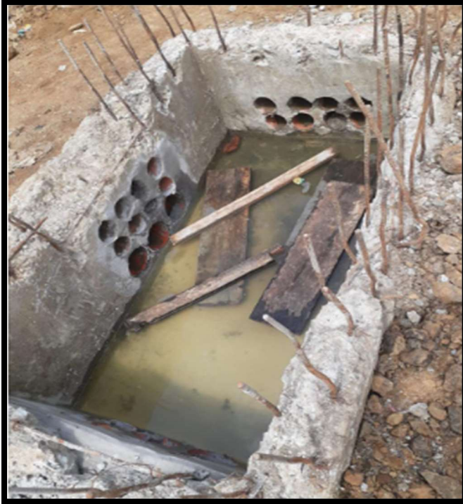
Figura. 21 Filtración presente en cajas de paso
