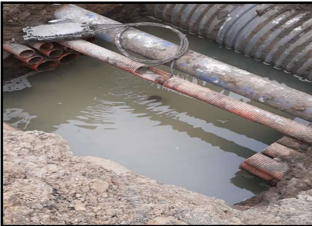
Figura. 20 Caja de paso con filtración de aguas
