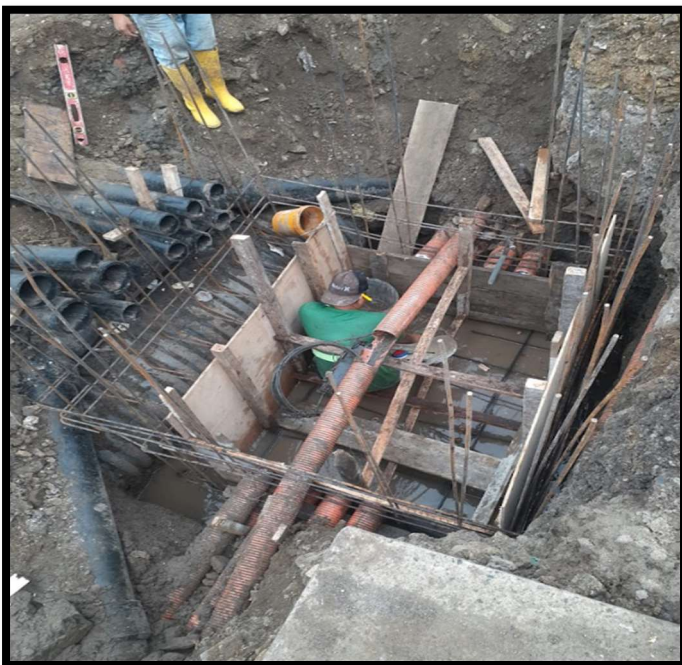
Figura. 3 Estructura de cajas de paso
