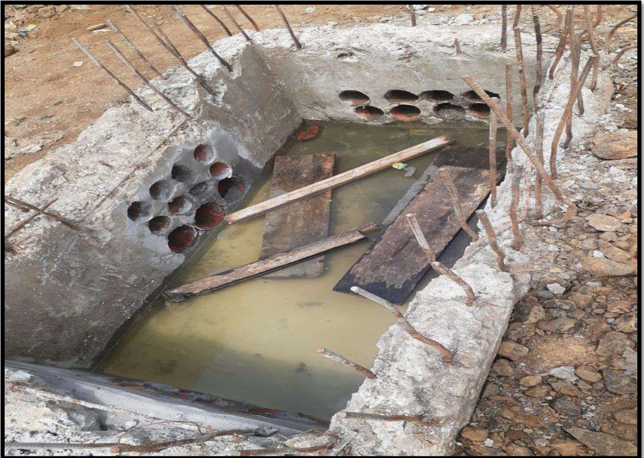
Figura. 19 Caja de paso con filtración de aguas.
