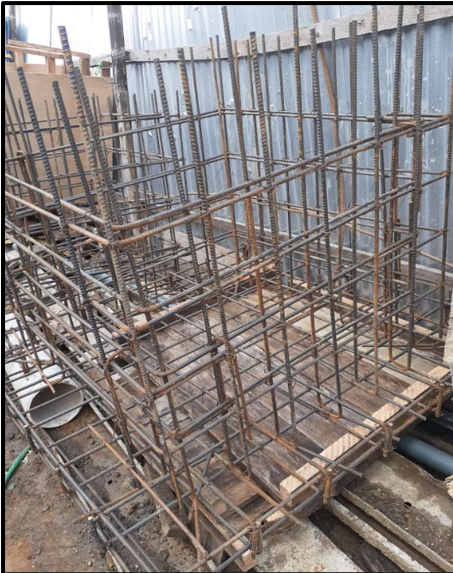
Figura. 15 Elemento estructural de cajas de paso.
