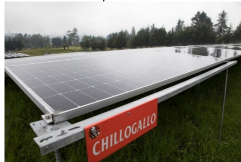
Ilustración 40. Panel solar usado para los restaurantes
