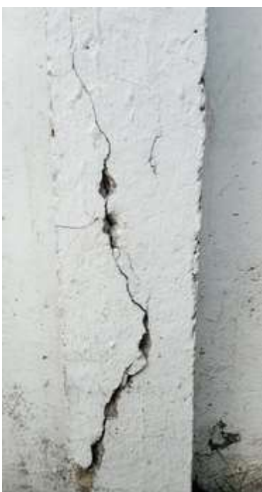
Figura 92 Efectos de sismo 2016
