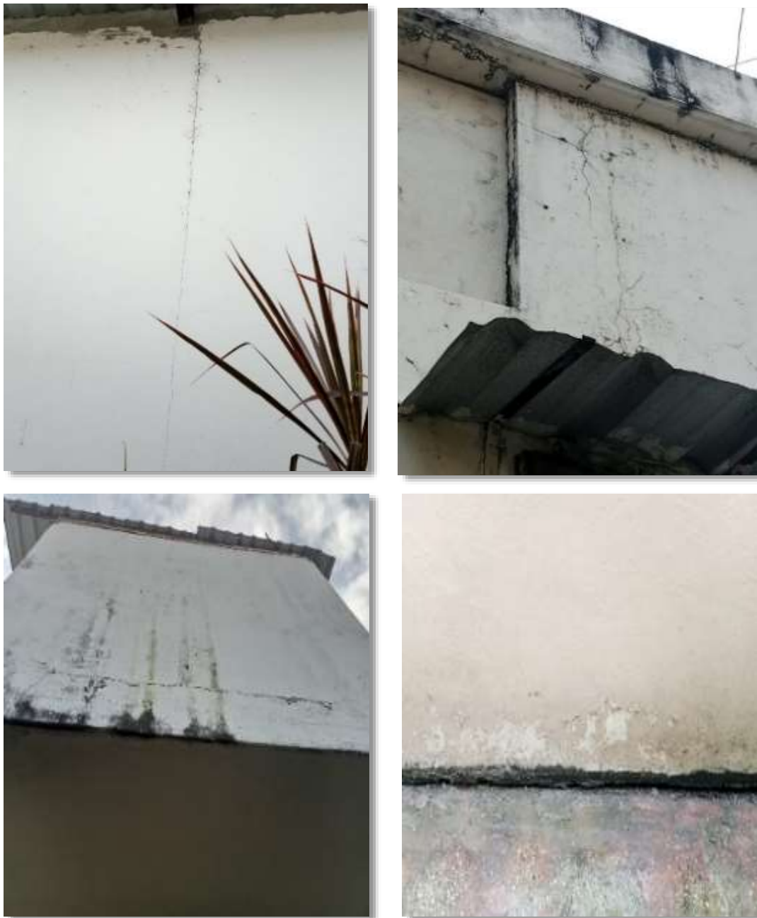
Figura 17 Fisuras presente en Paredes
