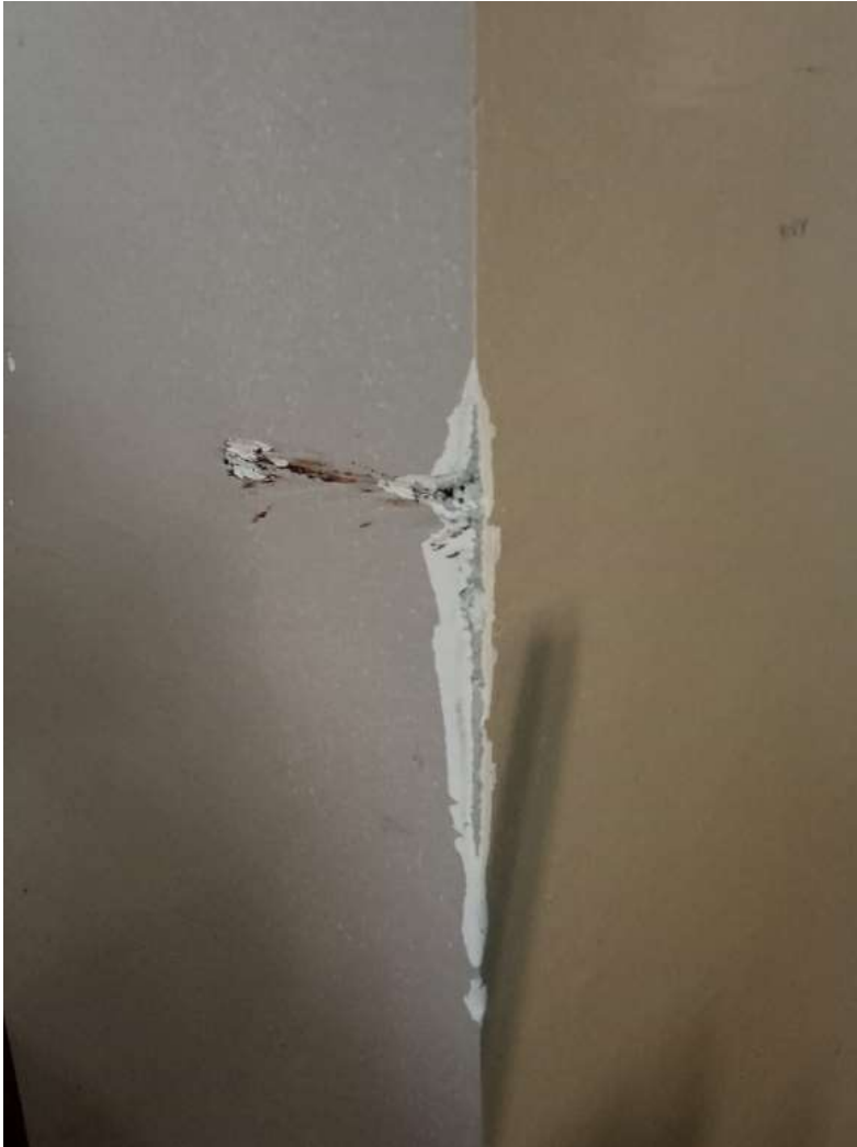
Figura 23 Fisura en Columna Estructural
