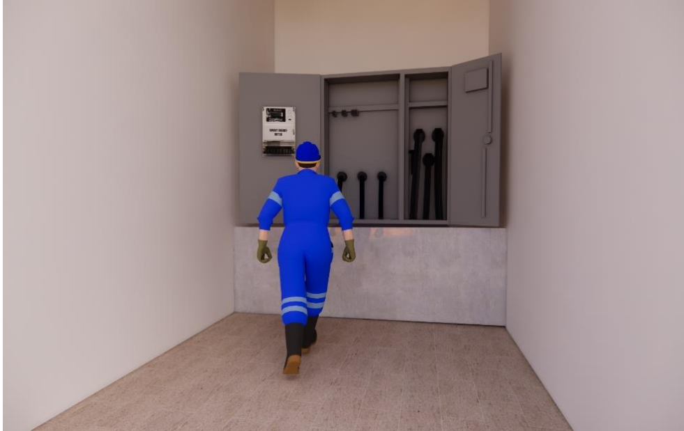
Figura 152. Cuarto de máquinas con contador inteligente de energía.
