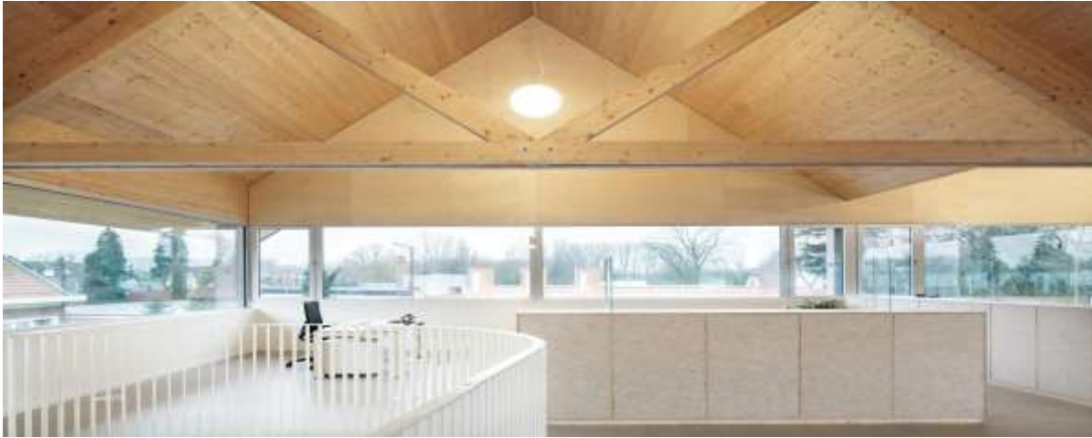
Figura 53. Clt usado en espacios interiores como sistema estructural
