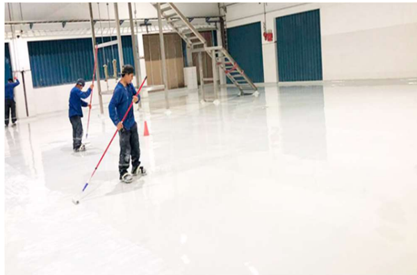
Ilustración 23: Pisos de Poliuretanos. Fuente: (CODEPA, 2022)
