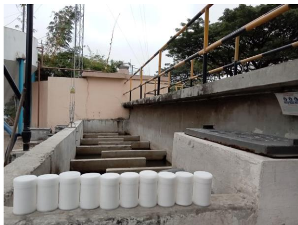
FIGURA 17. Área de Desinfección PTAR Entre Ríos
