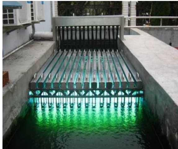
Figura 18. Área de Desinfección Lámparas Ultravioletas PTAR Rey Eduardo
