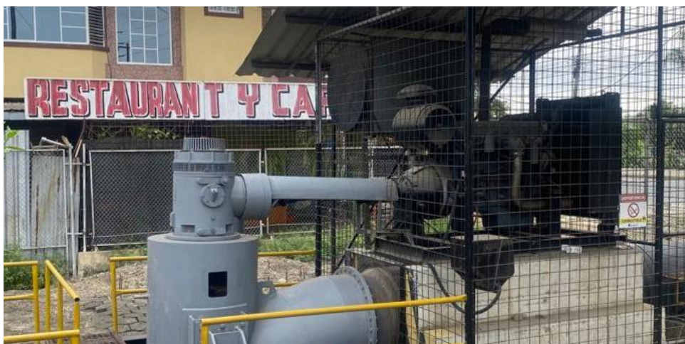
Figura 9. Bomba vertical axial, Motor estacionario.
