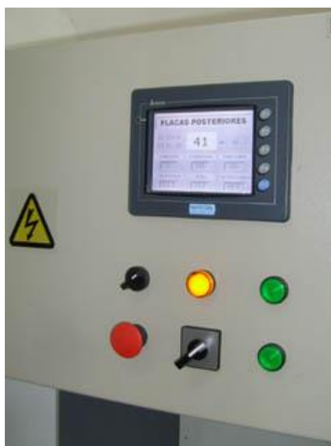
Figura 16. Tablero de control, con visualizador.
