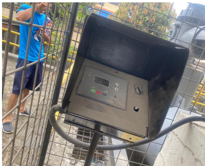
Figura 7. Panel de control, bomba tipo bananera.
