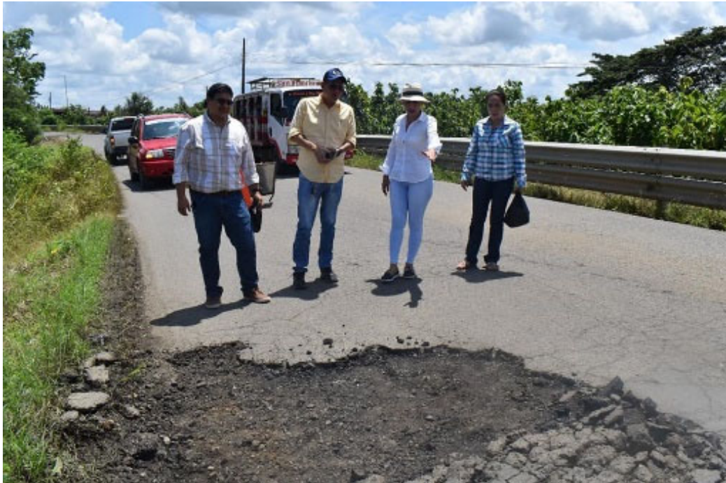
Figura 1. Deterioro de la vía Urdaneta – Caluma. Tomada de. Gobierno Autónomo Descentralizado Municipal del Cantón Urdaneta (2022).
