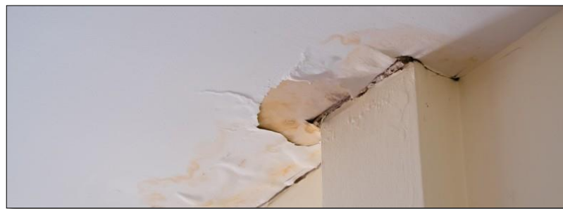
Figura 2: Presencia de humedades
