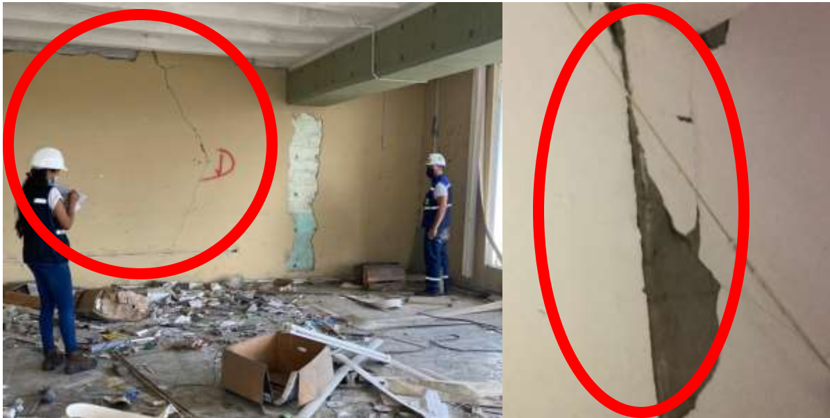
Ilustración 26. Grietas leves en paredes (Municipio de Esmeraldas)
