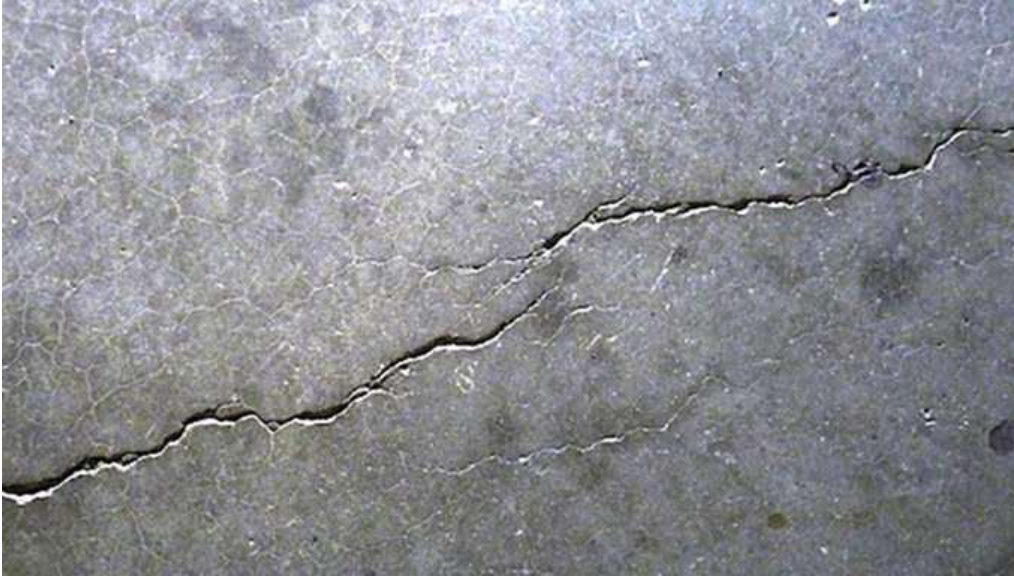
Ilustración 10. Contracción por secado
