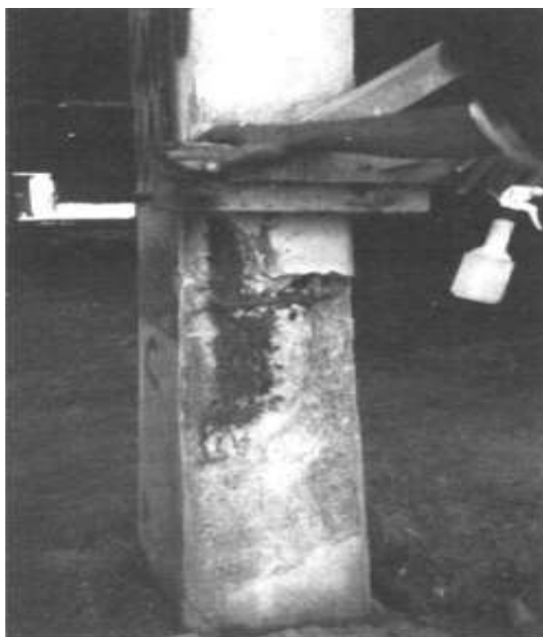
Ilustración 3. Estructura atacada por sales de amonio
