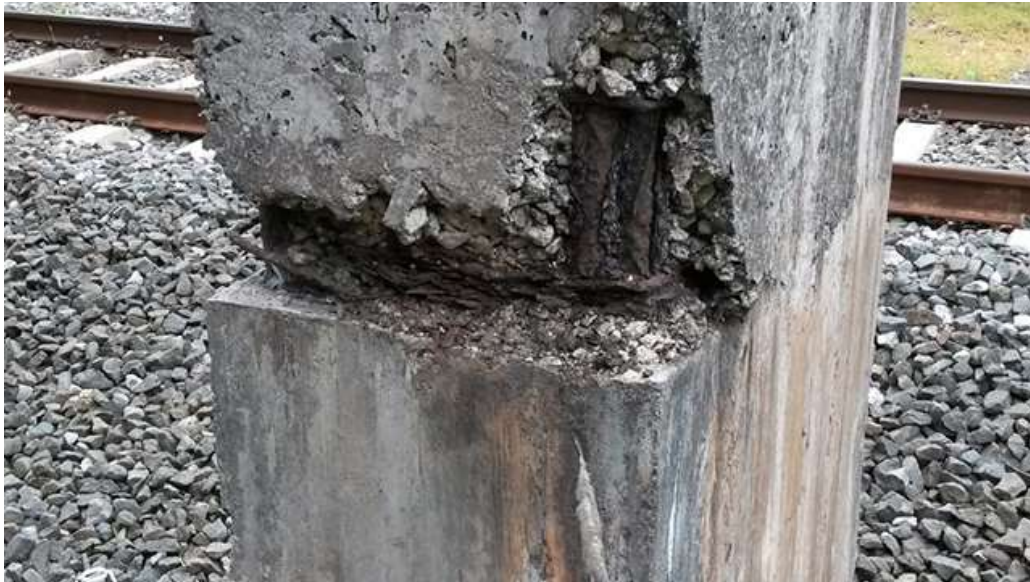
Ilustración 19. Daños en elementos estructurales.
