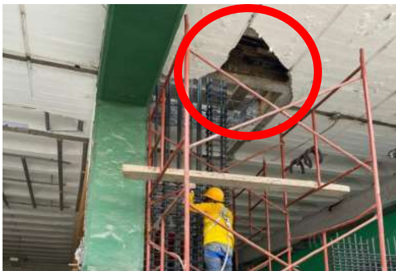
Ilustración 23. Rotura losa general en planta de Municipio de Esmeraldas
