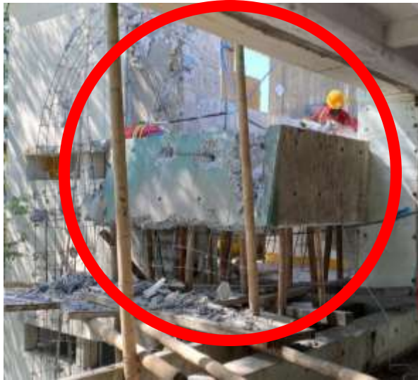
Ilustración 24. Colapso General de escaleras de Municipio de Esmeraldas
