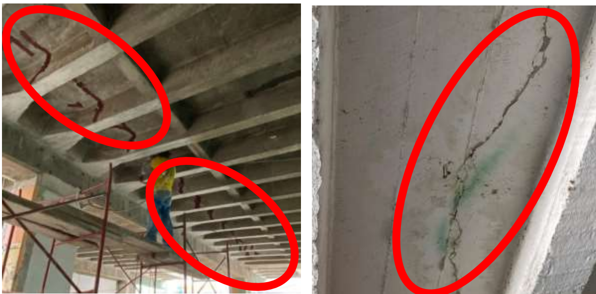
Ilustración 27. Grietas en losa (Municipio de Esmeraldas)
