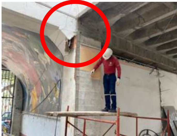
Ilustración 21. Rotura de columna edificio Municipal de Esmeraldas
