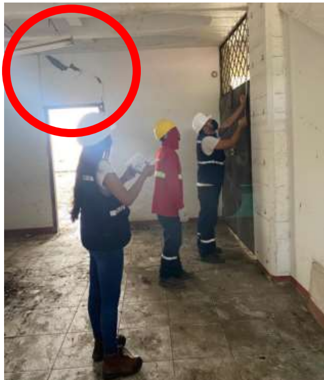
Ilustración 25. Grietas graves en paredes (Municipio Esmeraldas)
