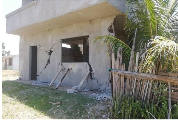
Figura 9: Daños materiales terremoto de Salinas - 2019
