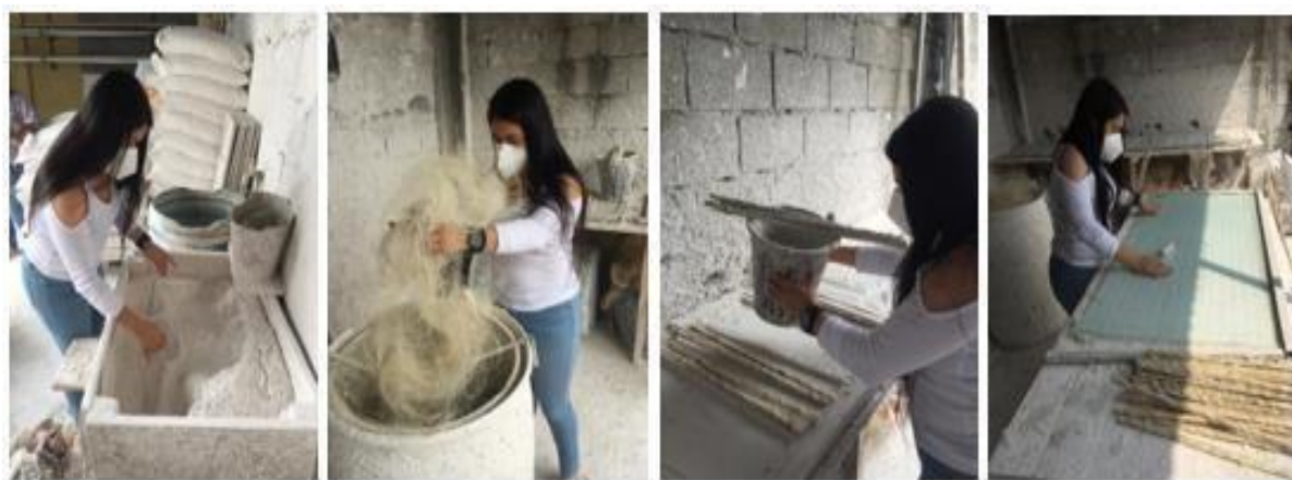
Figura 32. Elaboración de panel acústico y térmico con materiales reciclados Elaborado por: Álvarez (2022).
