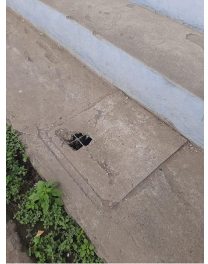
Ilustración 2 Evidencia 2 de fallas en obras
