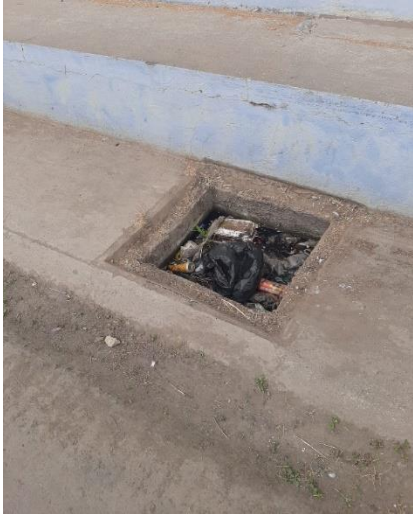
Ilustración 1 Evidencia 1 de fallas en obras
