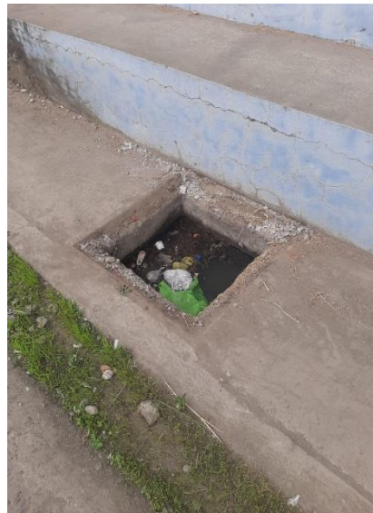
Ilustración 3 Evidencia 3 de fallas en obras
