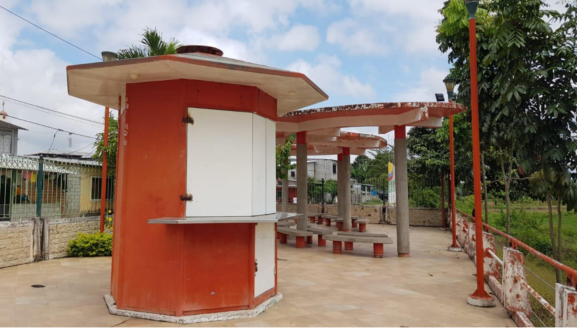
Anexo 9: Estado actual del malecón de la parroquia Palestina.
