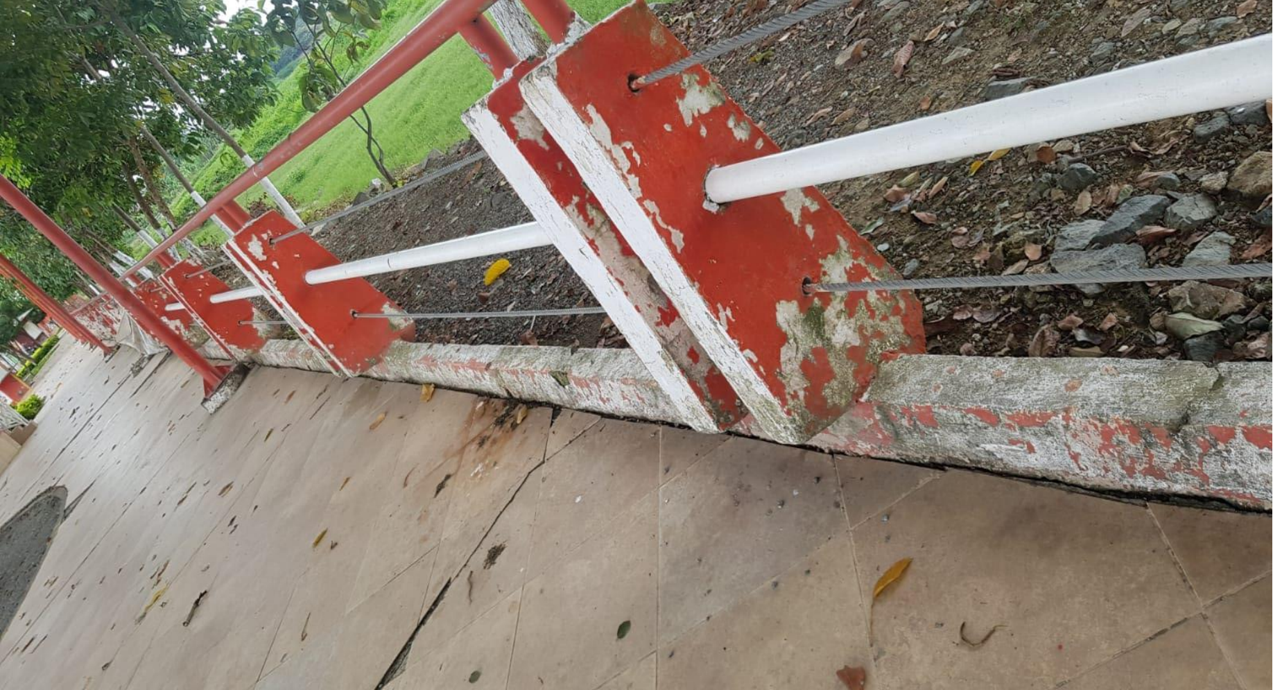
Anexo 12: Estado actual del malecón de la parroquia Palestina
