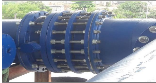
Figura 6. Junta de desmontaje. Fuente: EMAPAG-E.P.
