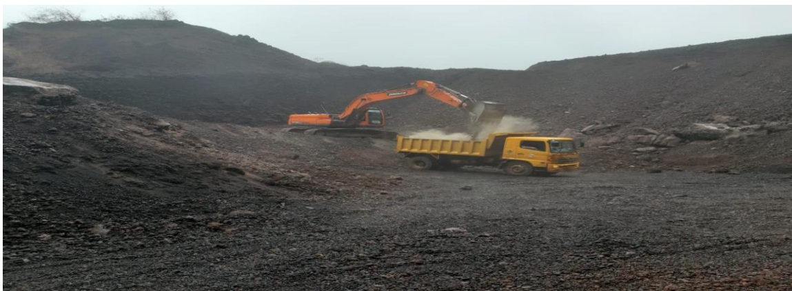
Figura 12. Presencia del polvo Abastecimiento de material Elaborado por: Santamaria, (2022)
