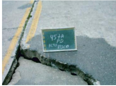
Imagen 31. Desportillado de rotura Fuente. IBCH, 2012
