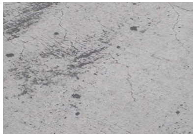
Imagen 29. Roturas localizadas Fuente. IBCH, 2012
