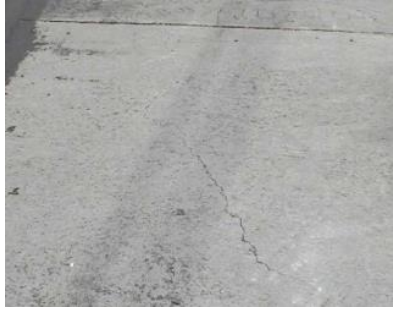
Imagen 28. Fisuras superficiales Fuente. IBCH, 2012
