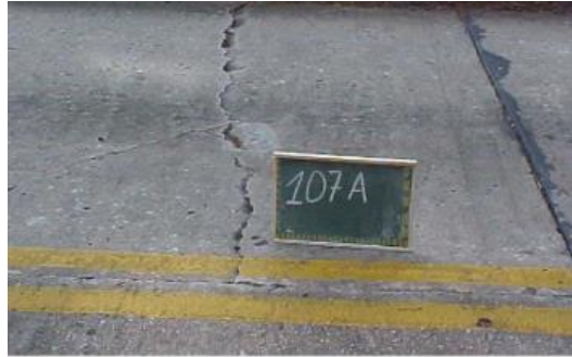
Imagen 22. Fisuras Transversales Fuente. IBCH, 2012
