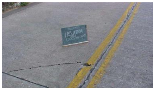
Imagen 19. Fisuras de esquina
