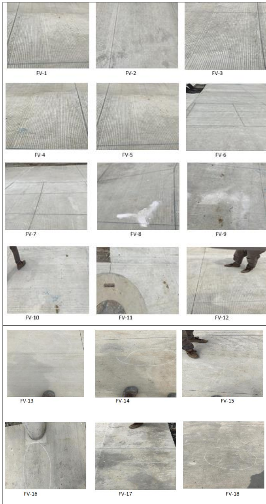
Imagen 58. Identificación de 18 fisuras lineales en los 30 paños de la calzada Elaborado por: Pozo, C. (2021)
