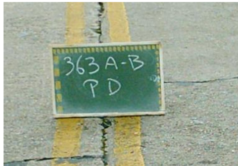
Imagen 21. Escalonamiento y falla de sellante Fuente. IBCH, 2012
