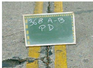
Imagen 30. Desportillado de juntas Fuente. IBCH, 2012
