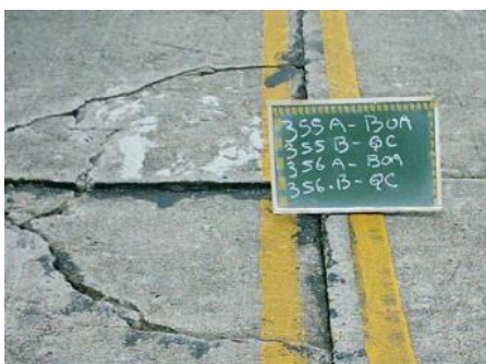
Imagen 26. Roturas localizadas Fuente. IBCH, 2012
