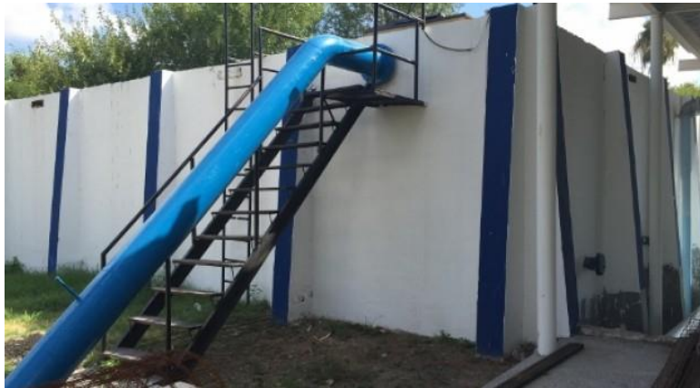
Figura 10 Tanque de regulación
