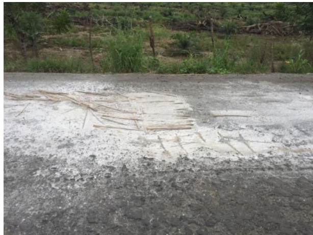
Ilustración 3 Mal estado de la vía. Elaborado por: López y Salazar (2022).
