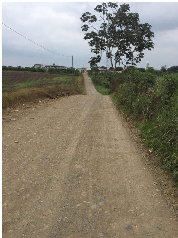
Ilustración 5 Tramo de la vía con carencia de la carpeta asfáltica. Elaborado por: López y Salazar (2022).
