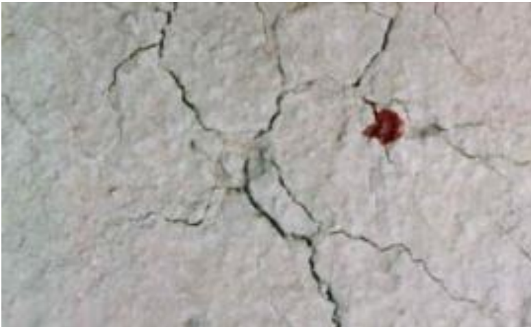
Figura 3. Fisura de retracción
