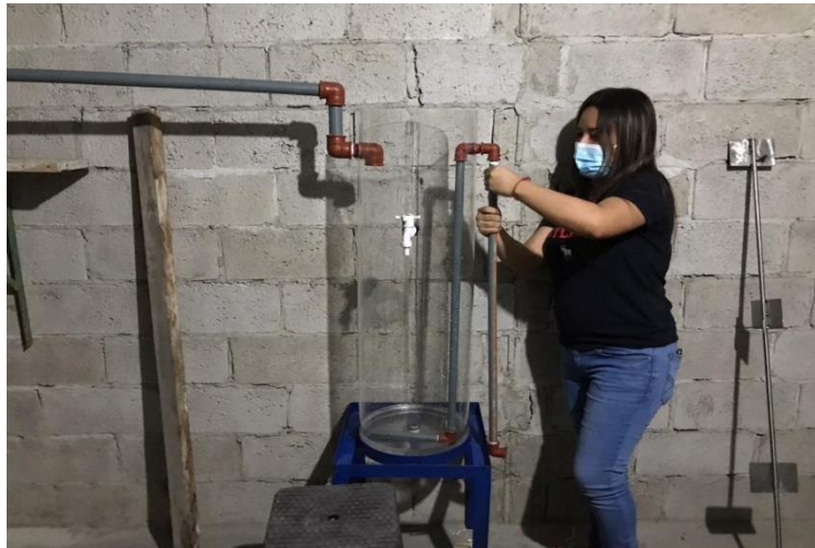
Ilustración 14: Conexiones de tuberías
