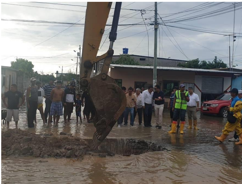
Figura 9. Inundaciones en Machala Fuente: (EL UNIVERSO, 2020)
