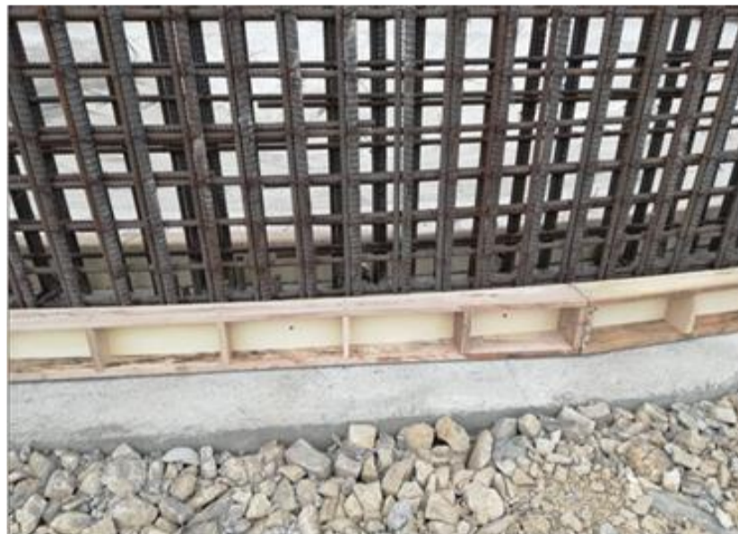
Figura 32. Imagen de tablero de arranque
