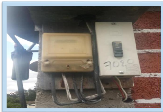
Caja en mal estado
