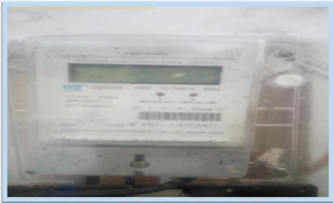
Medidor sin energía
