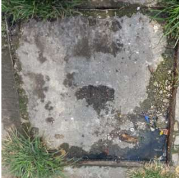
Figura 19.- Tapa Hormigón Armado del sistema de la red de alcantarillado. Elaborado por: Velasco (2021).
