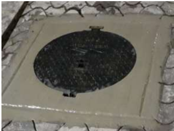
Figura 20.- Tapa metálica para el sistema de la red de alcantarillado. Elaborado por: Velasco (2021).
