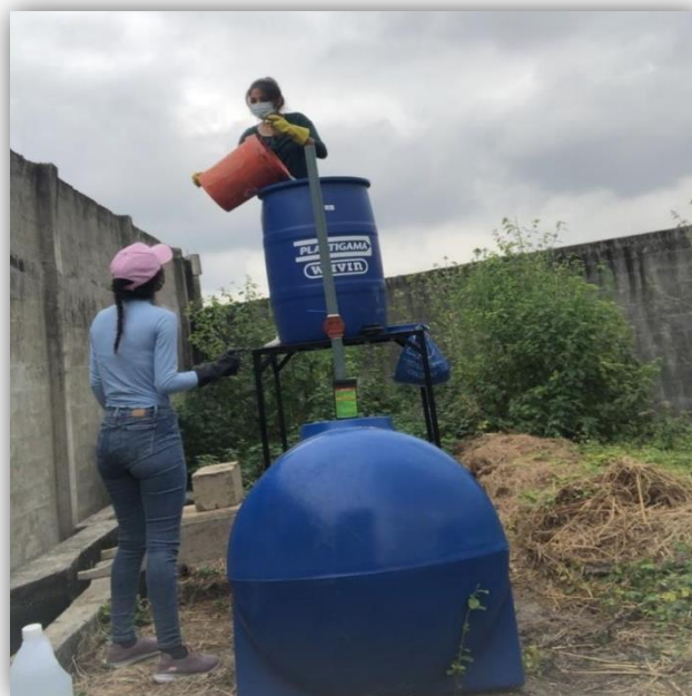
Ilustración 53. Abastecimiento del tanque con 405 lts de agua residual.
