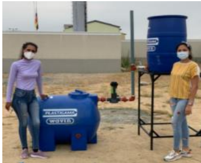
Ilustración 32. Planta Piloto instalada en la Urb. La Rioja. Elaborado por: Arana & Mancero (2021).
