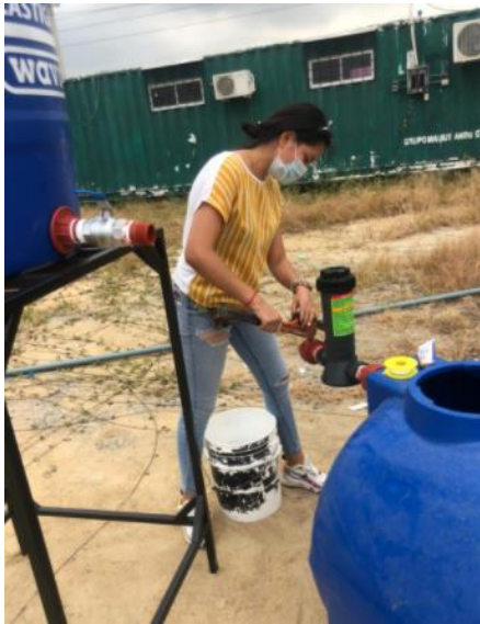
Ilustración 30. Instalación de clorinador para dosificación de pastillas de cloro. Elaborado por: Arana & Mancero (2021).
