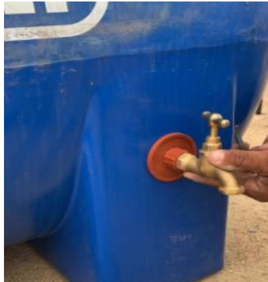
Ilustración 29. Instalación de llave de salida de agua residual con desinfectante. Elaborado por: Arana & Mancero (2021).
