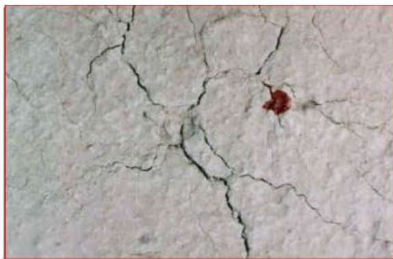
Figura 16: Fisuras de retracción
