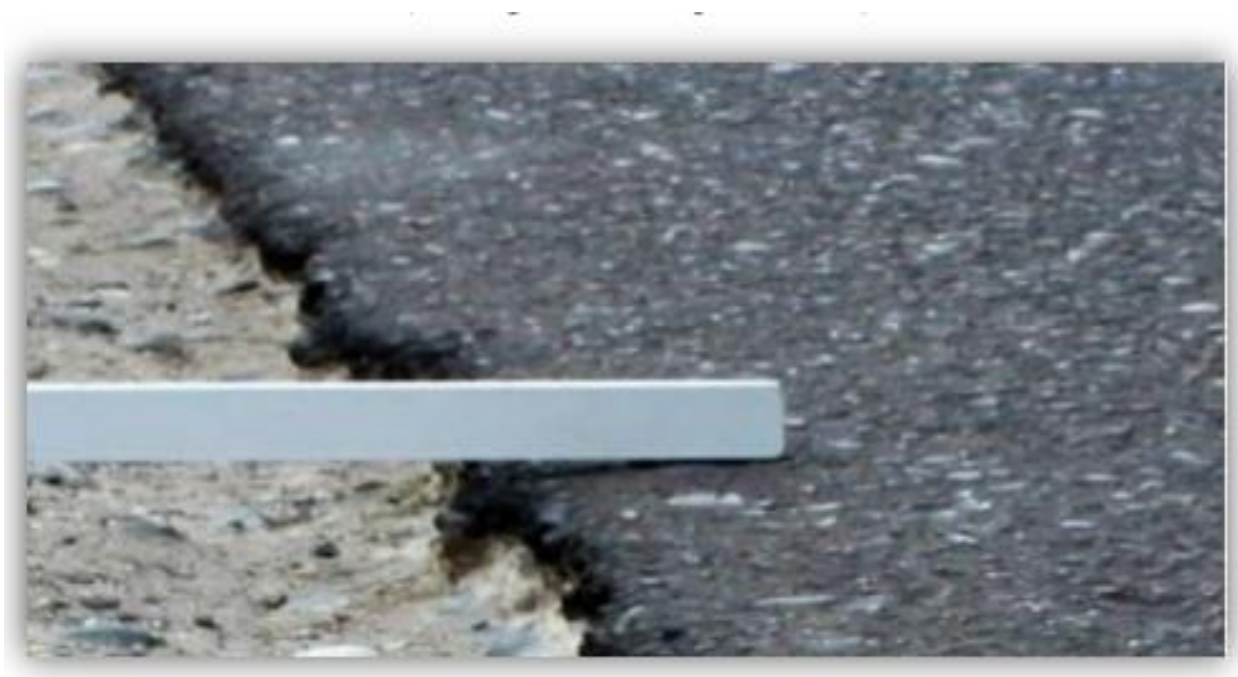
Figura 17 Desnivel carril/berma. Fuentes: (Pachay P, 2017)
