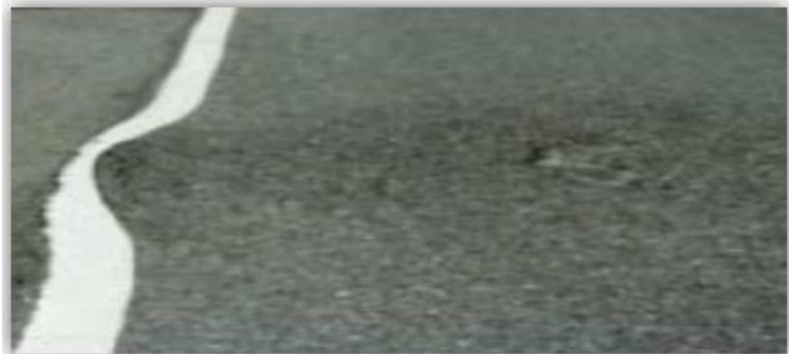
Figura 23 Desplazamiento Fuentes: (Pachay P, 2017)
