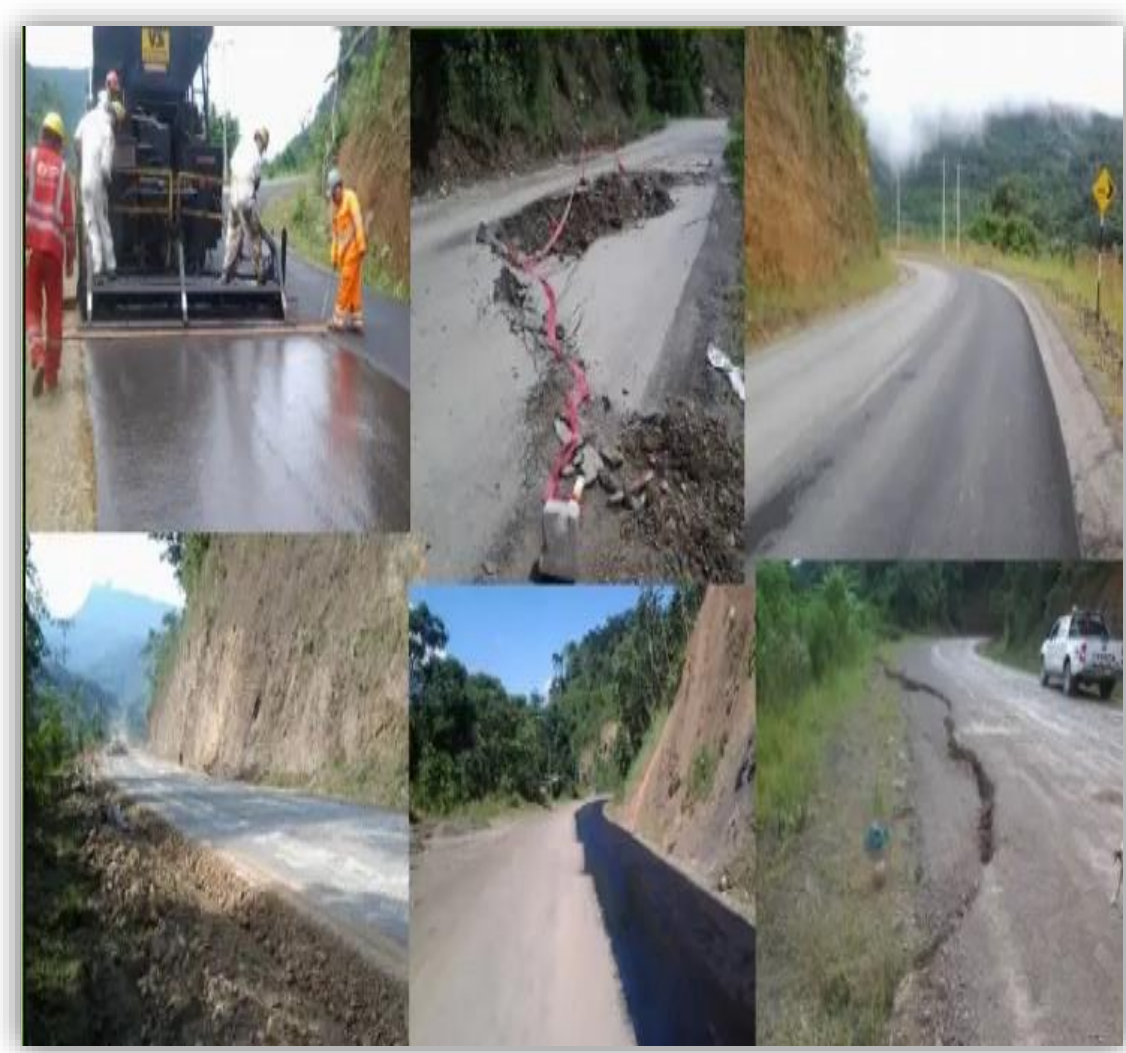
Figura 7 Deterioro del pavimento flexible.
