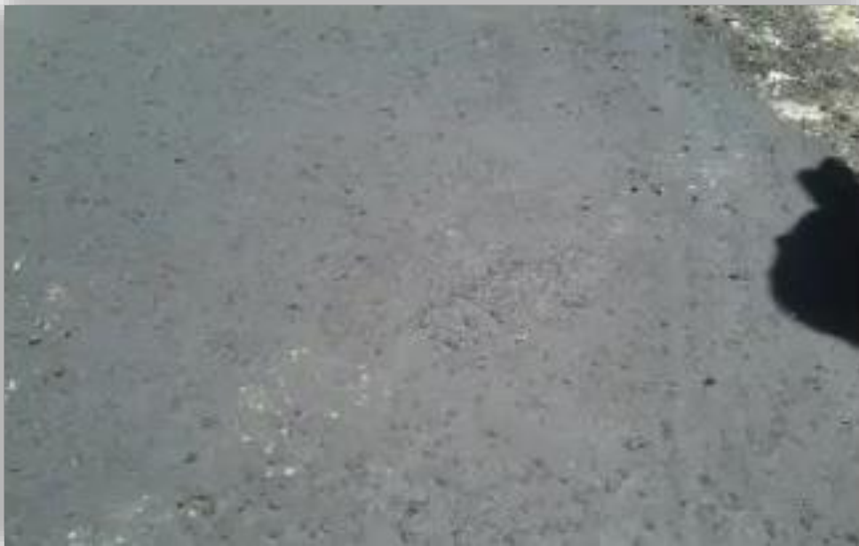
Figura 9 Exudación del ligante o asfalto llorado
