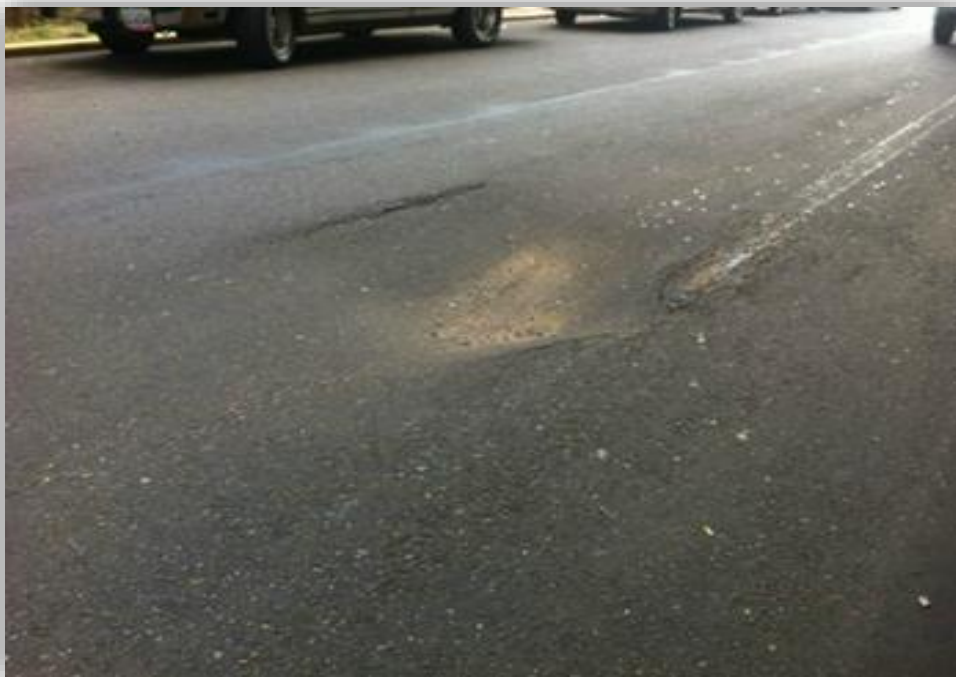
Figura 11 Hundimientos Fuentes: (Romero S, 2017)
