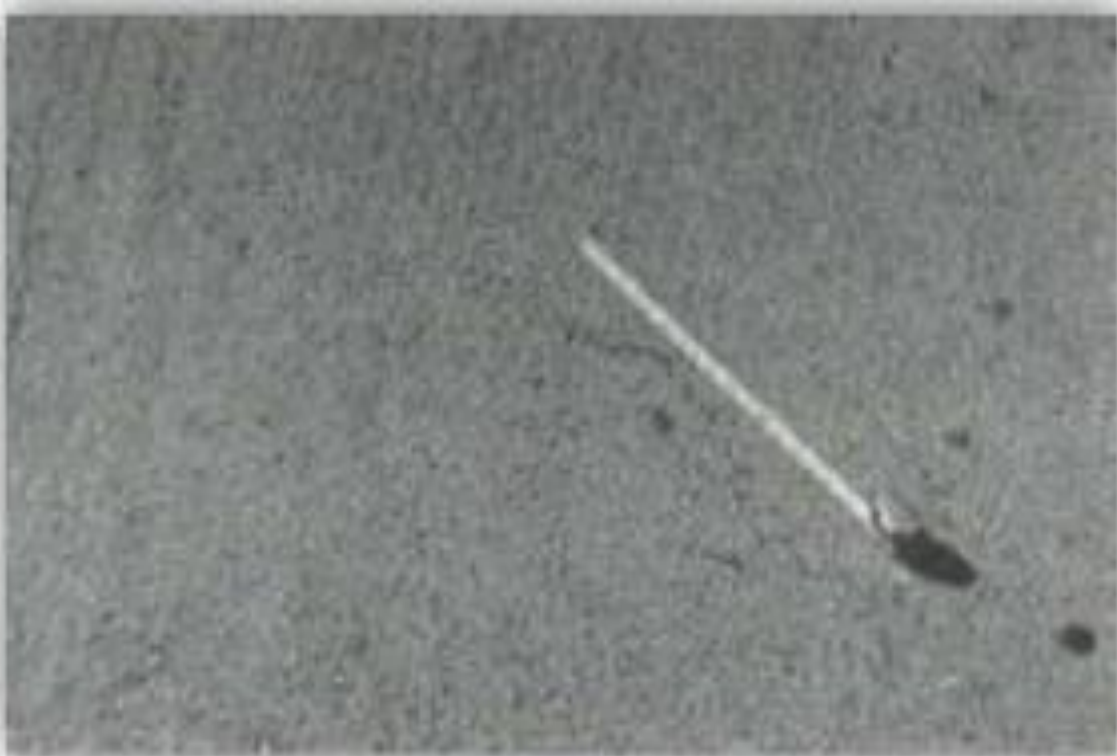
Figura 26 Grieta parabólica Fuentes: (Pachay P, 2017)
