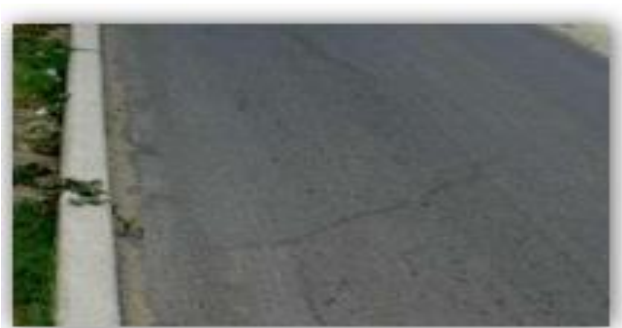
Figura 24 Grieta parabólica de severidad baja Fuentes: (Pachay P, 2017)
