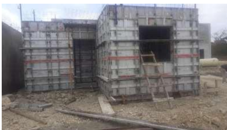
Figura 14. Registro fotográfico rubro Muros Planta Baja en proceso de preparación. Elaborado por: Garcés (2021)
