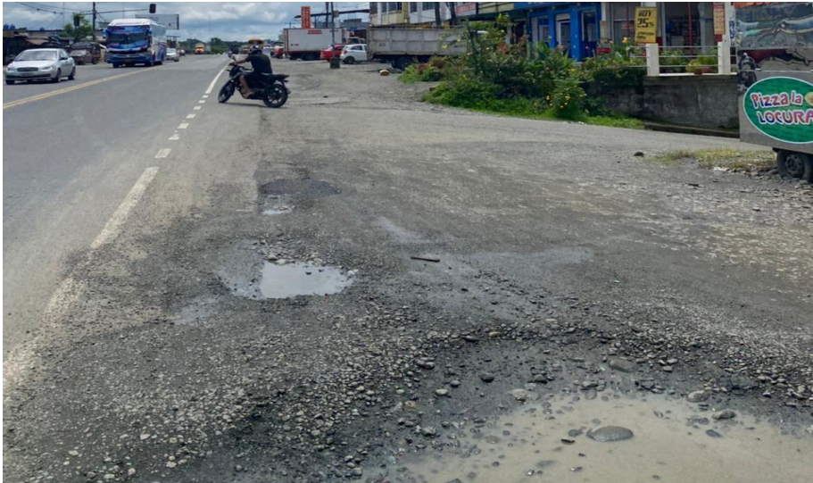
Anexo 5. Área de servicio en mal estado.
