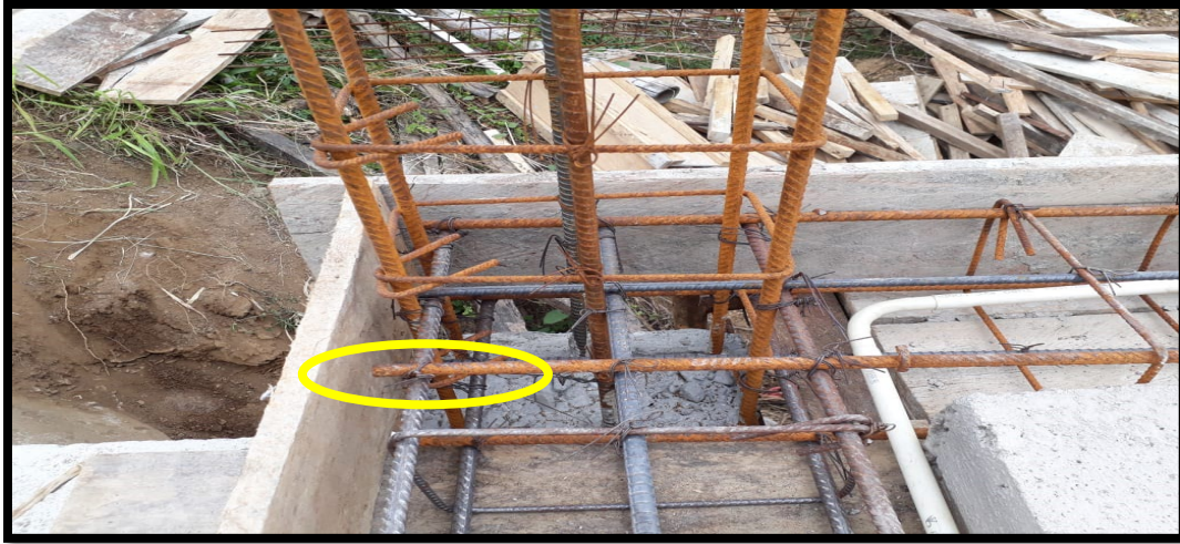
Ilustración 74 Falta de espacio entre encofrado
