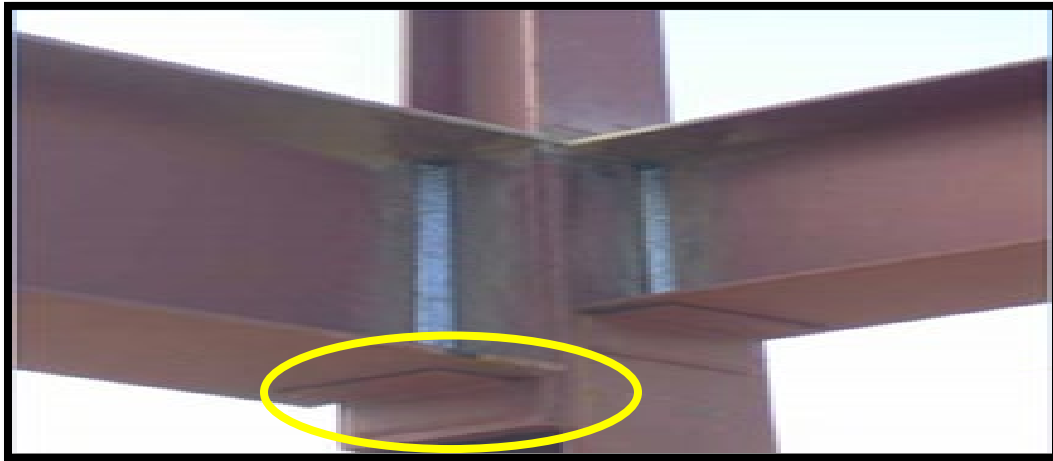
Ilustración 29 No remoción de ángulos de soportes en la conexión viga-comuna Elaborado: Benavides & Flores (2019)
