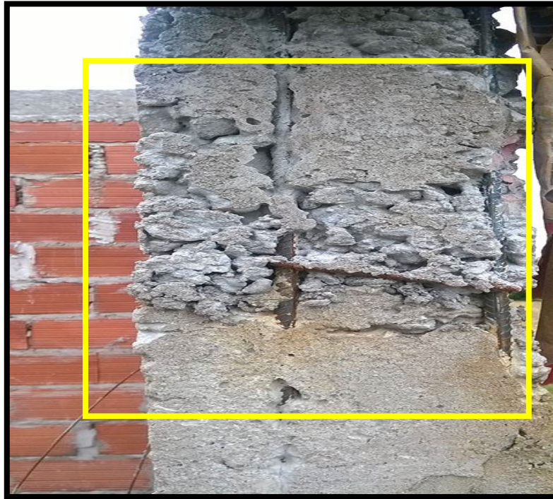
Ilustración 75 Mal dimensionamiento de estribos
