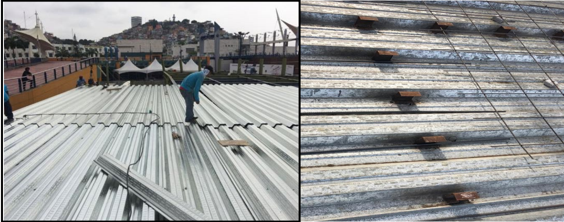
Ilustración 44 Falta de conectores de corte sobre vigas secundarias
