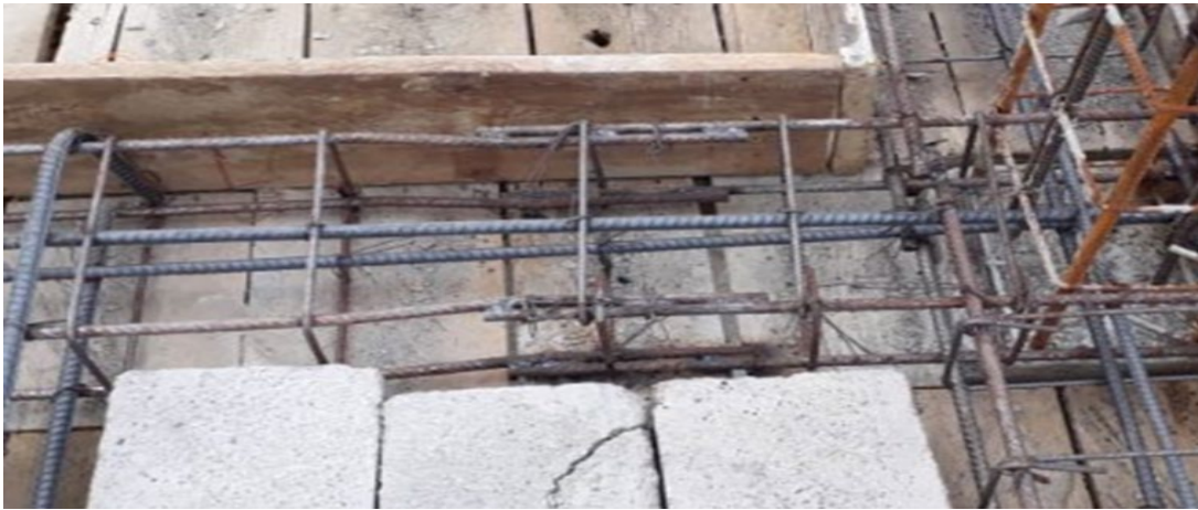
Ilustración 81 Mal armado de estribos en vigas de hormigón armado
