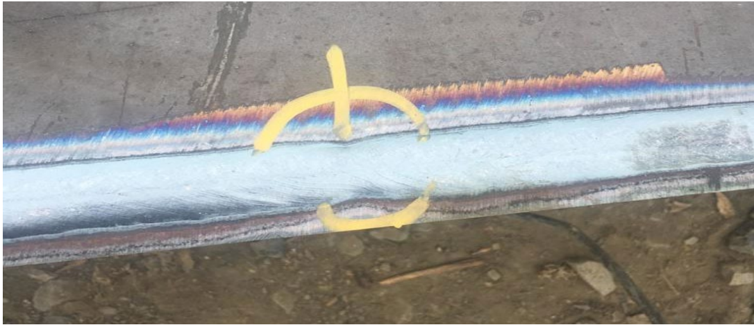
Ilustración 32 socavación en cordón de soldadura por penetración completa
