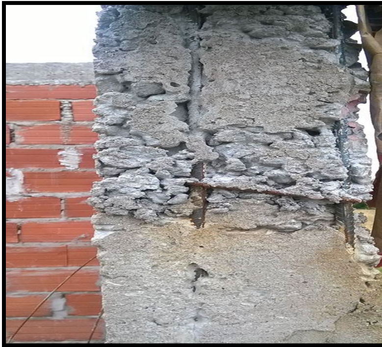
Ilustración 79 Hormigón mal colocado
