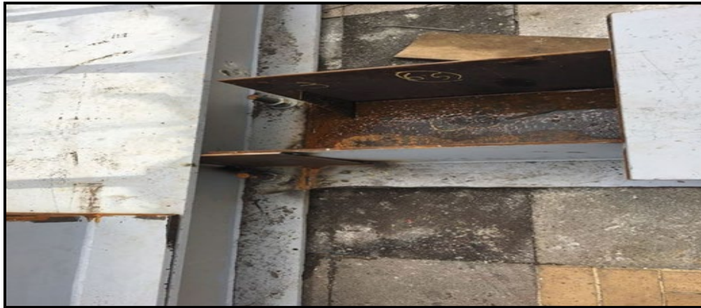
Ilustración 40 Contaminación de soldadura por cualquier hidrocarburo
