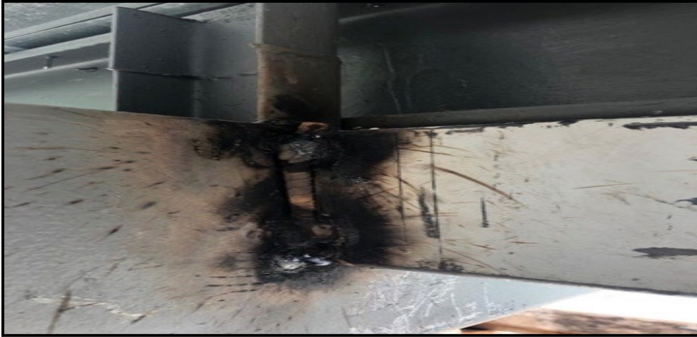
Ilustración 54 Mal uso de proceso de soldadura
