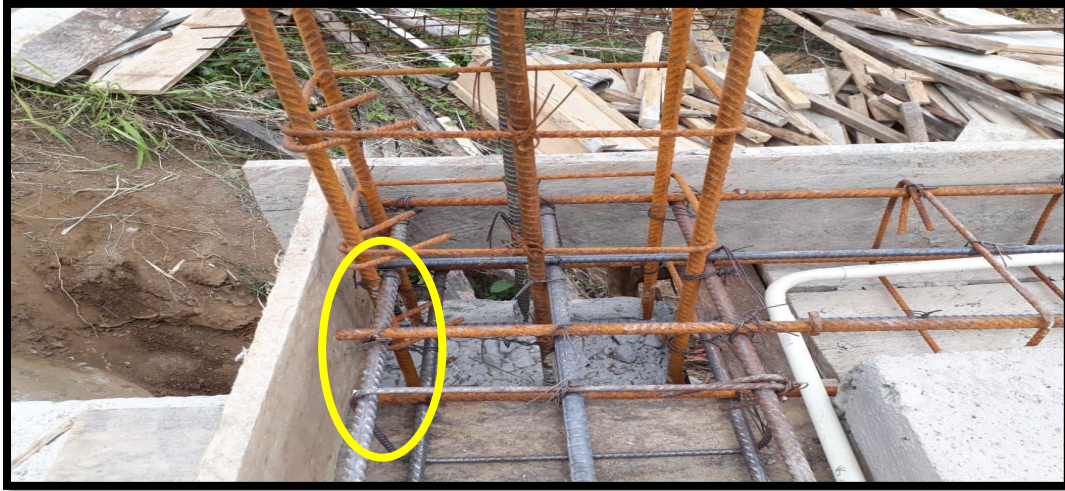
Ilustración 65 Falta de espacio entre encofrado
