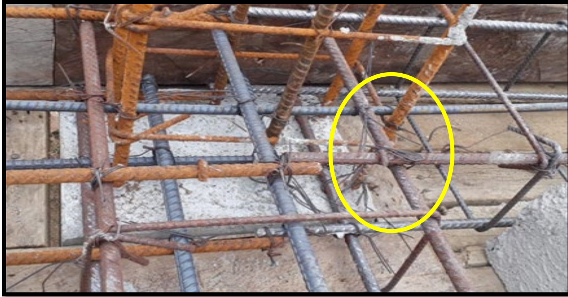
Ilustración 64 Traslape incorrecto en barra de refuerzo
