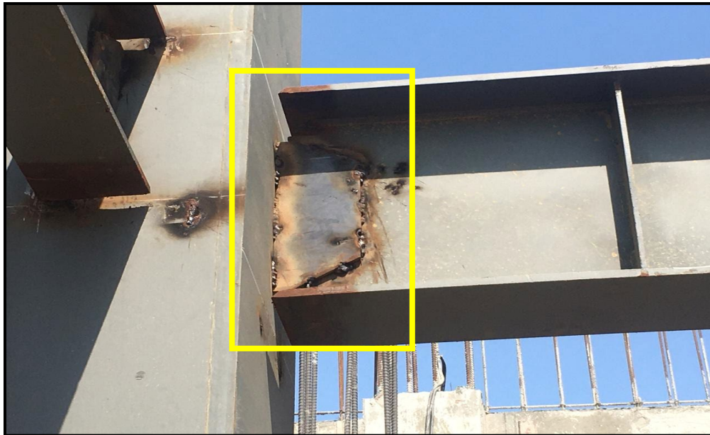
Ilustración 9: Pérdida de material base en placa de corte
