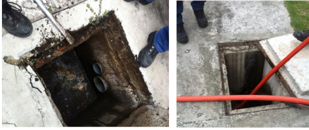
Figura 20. Recolección de aguas residuales domésticas en sector Colibrí
