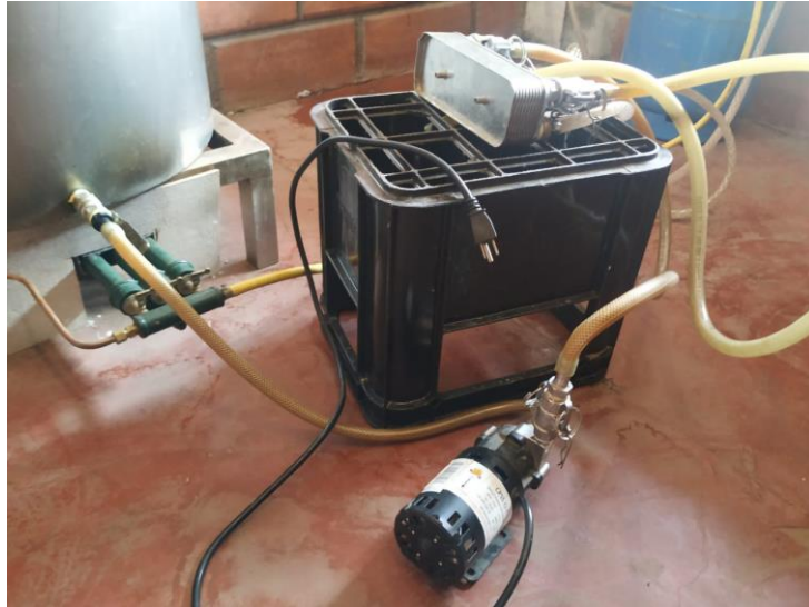
Foto 8. Bomba y enfriador de placas Fuente: SAMBA Elaborado por: Solano, M. (2020)
