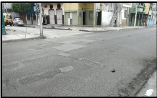
Figura 23 Deterioro superficial en la ciudad de Guayaquil
