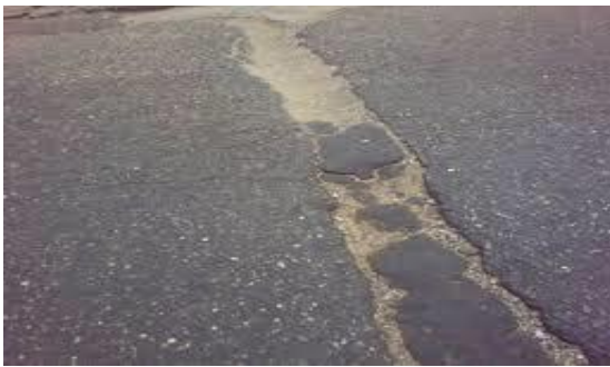
Figura 17 Pérdida de áridos
