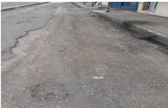
Figura 48 Pérdida de áridos
