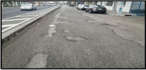
Figura 24 Baches en carpeta asfáltica y tratamiento superficiales en la ciudad de Guayaquil
