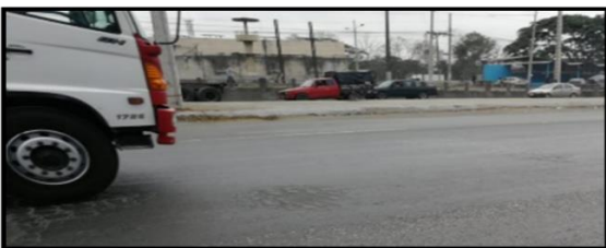
Figura 21 Fisuras y grietas en bloque en la ciudad de Guayaquil
