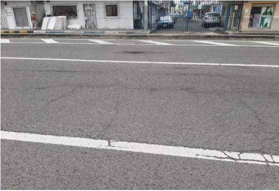
Figura 39 Fisuras y grietas longitudinales y transversales en la zona de estudio en la ciudad de Guayaquil Tomado por: Bueno & Pilay (2019)
