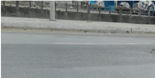
Figura 21 Fisuras y grietas por fatigamiento en la ciudad de Guayaquil
