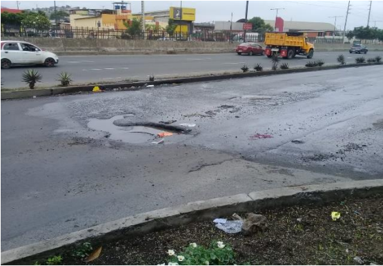
Figura 44 Baches en carpetas asfálticas y tratamientos superficiales en la zona de estudio en la ciudad de Guayaquil
