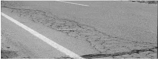
Figura 7 Fisuras y grietas en bloque.
