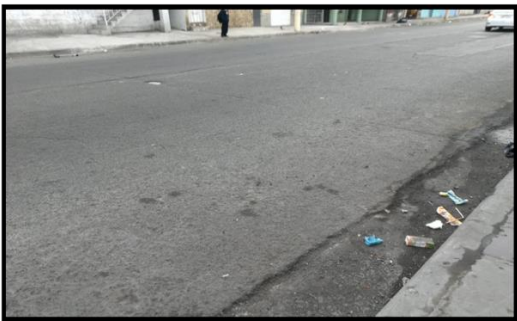
Figura 22. Fisuras y grietas longitudinales y transversales en la ciudad de Guayaquil
