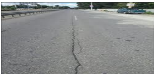
Figura 9 Fisuras y grietas longitudinales y transversales.
