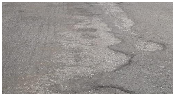
Figura 49 Pérdida de áridos
