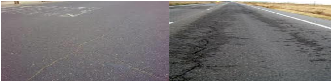
Figura 6 Fisuras y grietas por fatiga miento.
