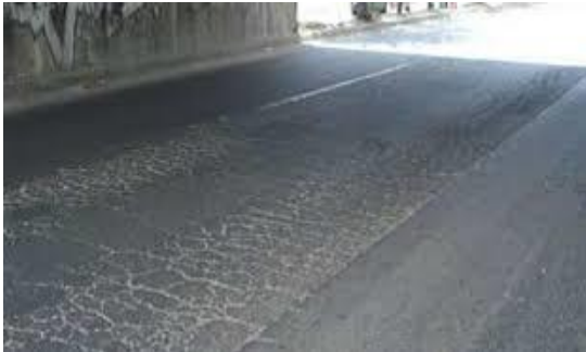
Figura 10 Fisuras y grietas Reflejadas.
