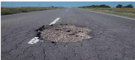
Figura 14 Baches en carpetas asfálticas y tratamientos superficiales.
