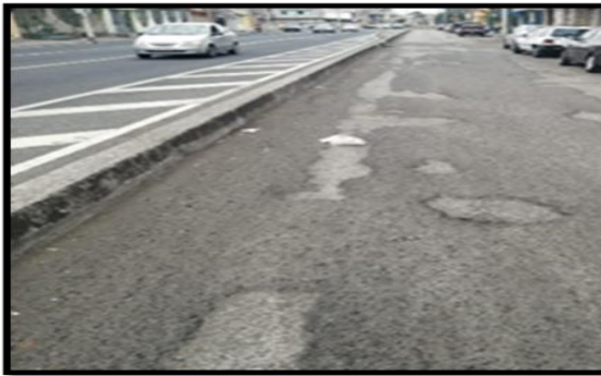
Figura 43 Baches en carpetas asfálticas y tratamientos superficiales en la zona de estudio en la ciudad de Guayaquil
