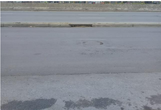
Figura 40 Fisuras y grietas longitudinales y transversales en la zona de estudio en la ciudad de Guayaquil Tomado por: Bueno & Pilay (2019)
