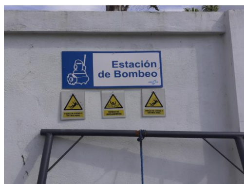
Figura 23: Estación de bombeo urbanización laguna del sol (planta de tratamiento de lodos activados) Elaborado por: Blanco & Guzmán. (2020)
