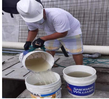
Figura 25: Extracción del agua residual Elaborado por: Blanco & Guzmán. (2020)
