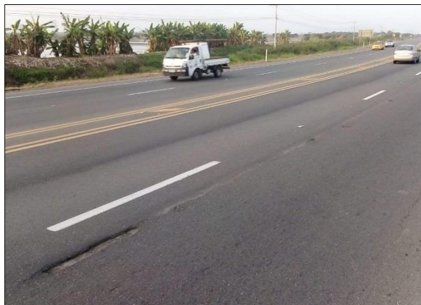
Imagen 4. Capa de rodadura con baches. Fuente: Captura propia Elaborado por: Nazareno & Sánchez (2020)
