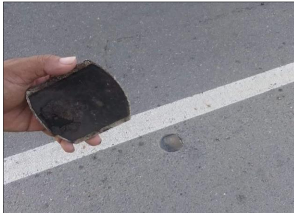
Imagen 3. Tachas desprendida de la calzada. Fuente: Captura propia Elaborado por: Nazareno & Sánchez (2020)
