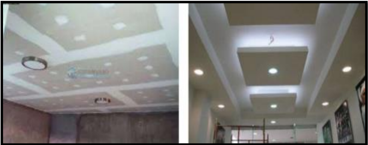
Figura 12: Panel de tumbado de yeso tipo Drywall
