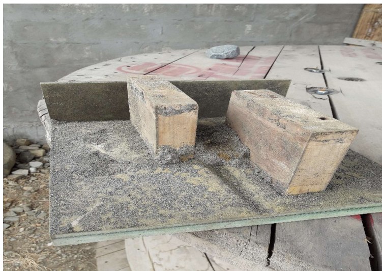
Imagen 44 molde afectado al desencofrar
