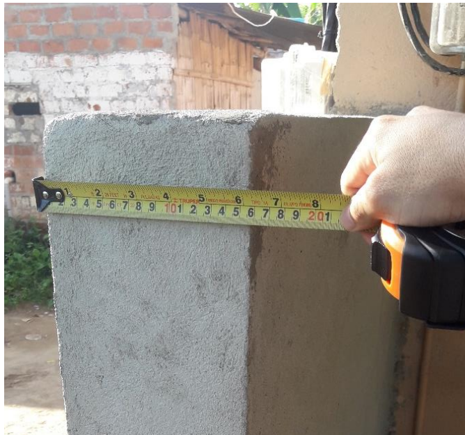
Figura 63 Medición de espesor de pared Tomado por: Santos, M. (2019).
